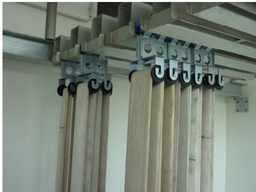
Durch die Neigung der Schlauchbahnen, rollen die Adapter automatisch zur Entnahme zum Anfang der Bahnen
