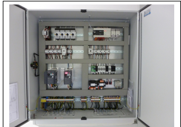
(Schaltschrank mit wartungsfreier SPS Steuerung)
